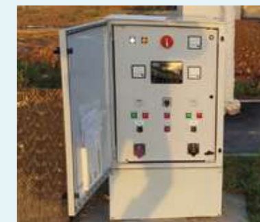
Armoire de commande
