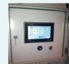
GTC (Gestion Technique Centralisée)
